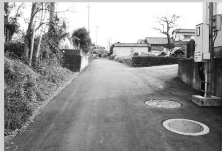
引間地区において下水道工事後の仮舗装の復旧および、豪雨時の住宅への浸水対策のため排水溝を設置
